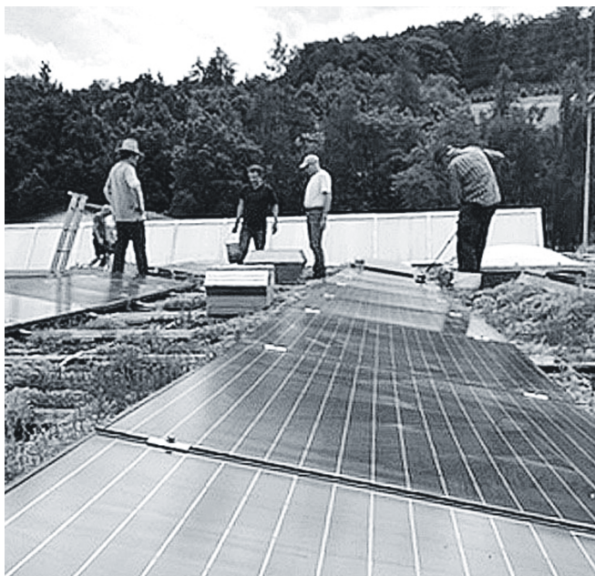
Wartung der PV-Anlage auf der Bezirksschule Endingen
